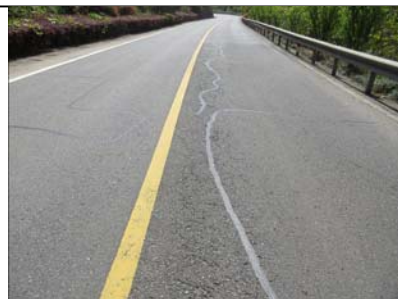
裂缝修补及龟裂
